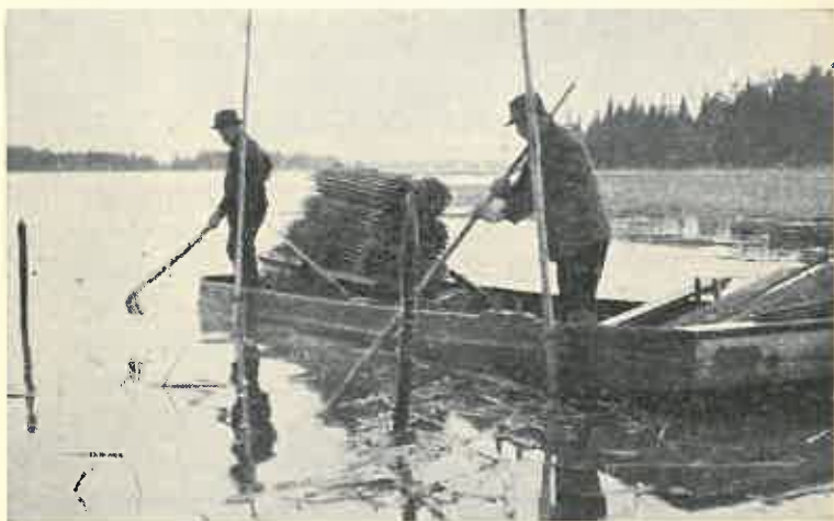
Bild 75. Kats huvudets »huvudpålar» ha placerats på sin plats och botten, där kats huvudet skall utsättas, befräas med gräfte från rötter av säv och näckros. C. Segerstråle foto
